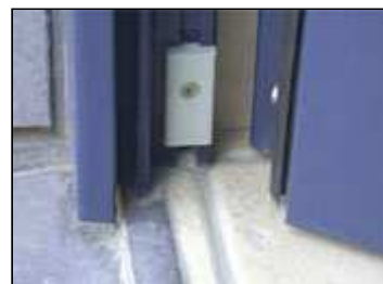
Afb. 1 Onjuiste plaatsing van de deurdorpel : de aanslag van de guillotineplint bevindt zich achter de opkant van de dorpel.
