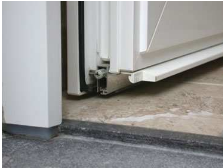
Deur van PVC : onderbreking tussen de guillotineplint en de luchtdichtingsstrip onder de onderste aanslag van de vleugel
