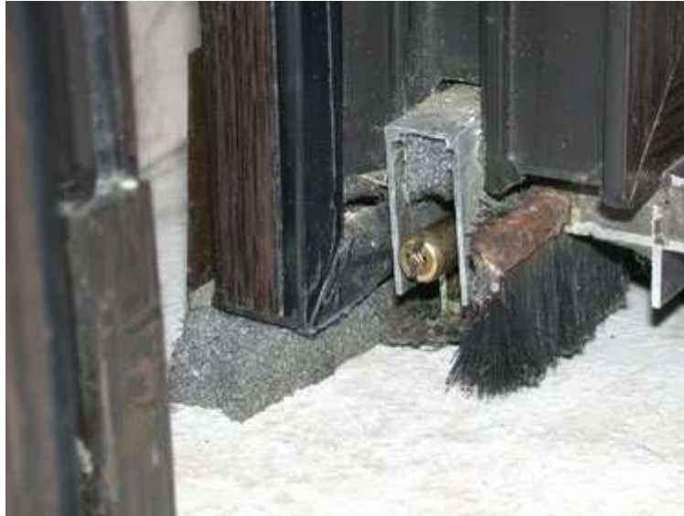
Vlakke dorpel : gebrekkige dichtheid ondanks de aanwezigheid van een borstelvoeg, een guillotineplint en een profiel van cellenschuim
